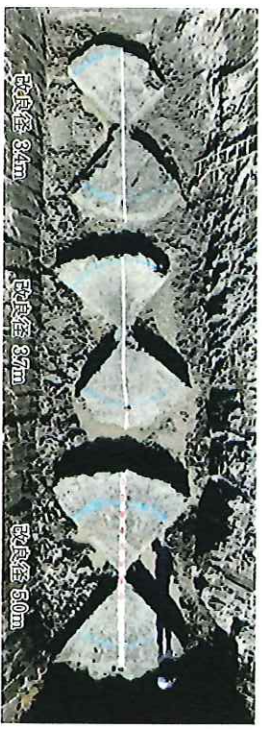
写真-1 改良体の露出状況全景 (事例No.1)
